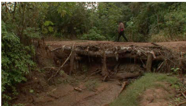
Puente para topadora impide el drenaje
